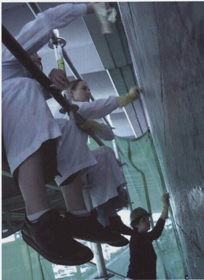
9. Una part de l'equip treballant en l'eliminació mecànica del vernís (Fotografia: Pau Maynés Tolosa).
