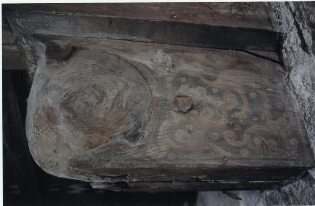
Mènsula 5 (biga 3), abans de la intervenció (Fotografia: ESCRBC).
