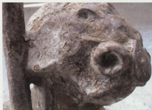
5. Detall de la corrosió del suport (Fotografia: Montserrat Artigau).
