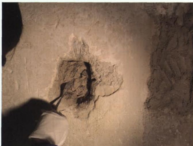
4. Aplicació de morter en un orifici profund. Es feu servir morter d'alta granulometria que incloïa picadís de teula (Fotografia de les autores).
