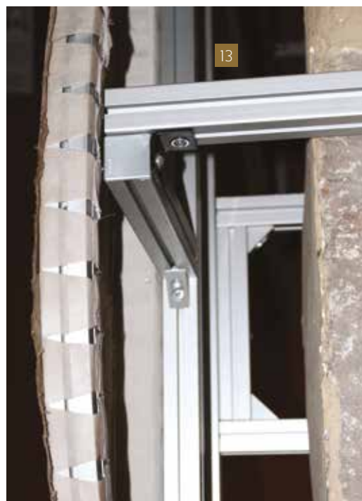
[12] Procés d'instal·lació de l'estructura auxiliar de suport i del monument a la capella de l'Hospici d'Illa.
