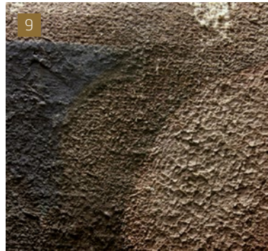
[8]. Detall de la superfície pictòrica amb butllofes.
