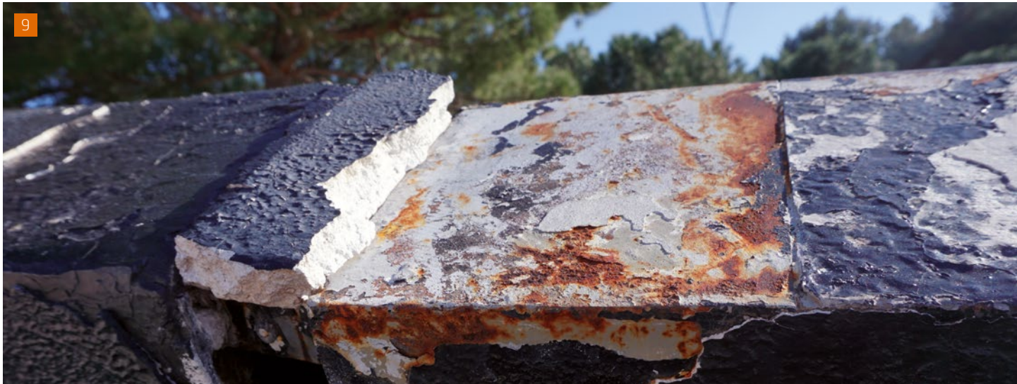
[9] Pèrdua del revestiment de resina, que ha deixat al descobert l'estructura metàl·lica interna, la qual presenta corrosió (Fotografia: Sara Hernández).
