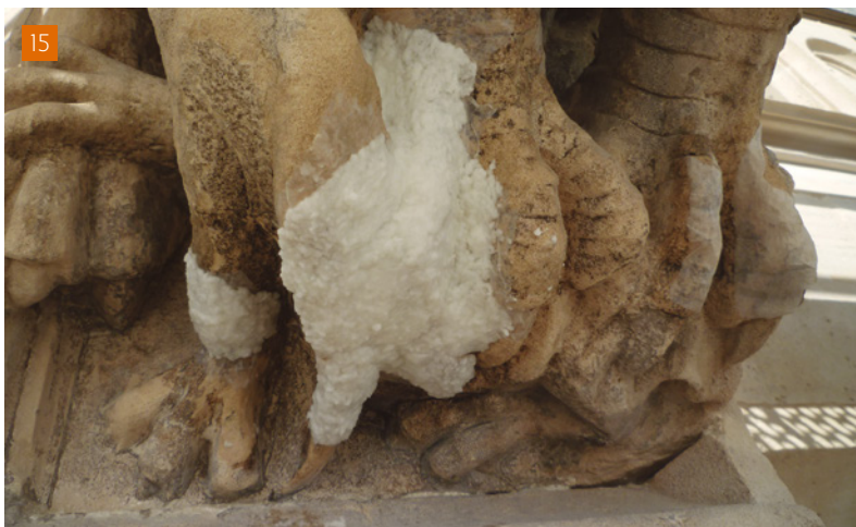
[15] Detall de la zona inferior de la gàrgola 1 durant el procés d'extracció de sals solubles (Fotografies: E. Planells).
