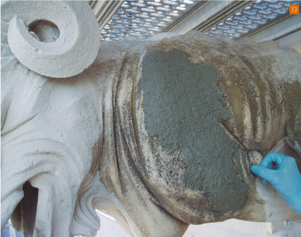
[13] Imatge de l'aplicació d'apòsits de papetta AB-57 a la gàrgola 6 per facilitar l'eliminació de l'atac biològic (Fotografia: E. Planells).
