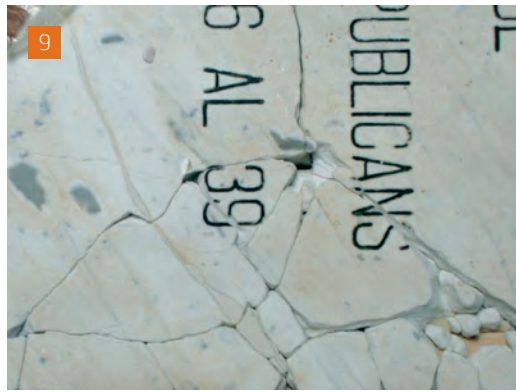
[9] Detall de les fractures radial i horitzontal.
