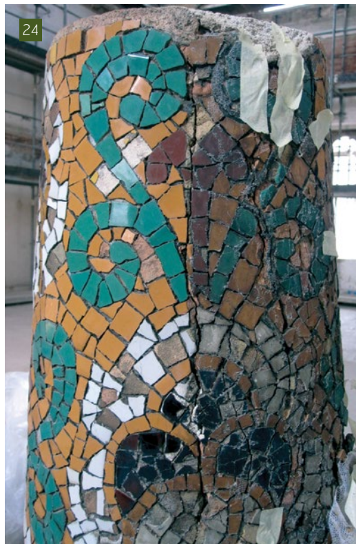
[24] Fractura provocada per l'augment de volum del metall de l'armadura interna de ferro, tram Q P3 (Fotografia: Àbac).
