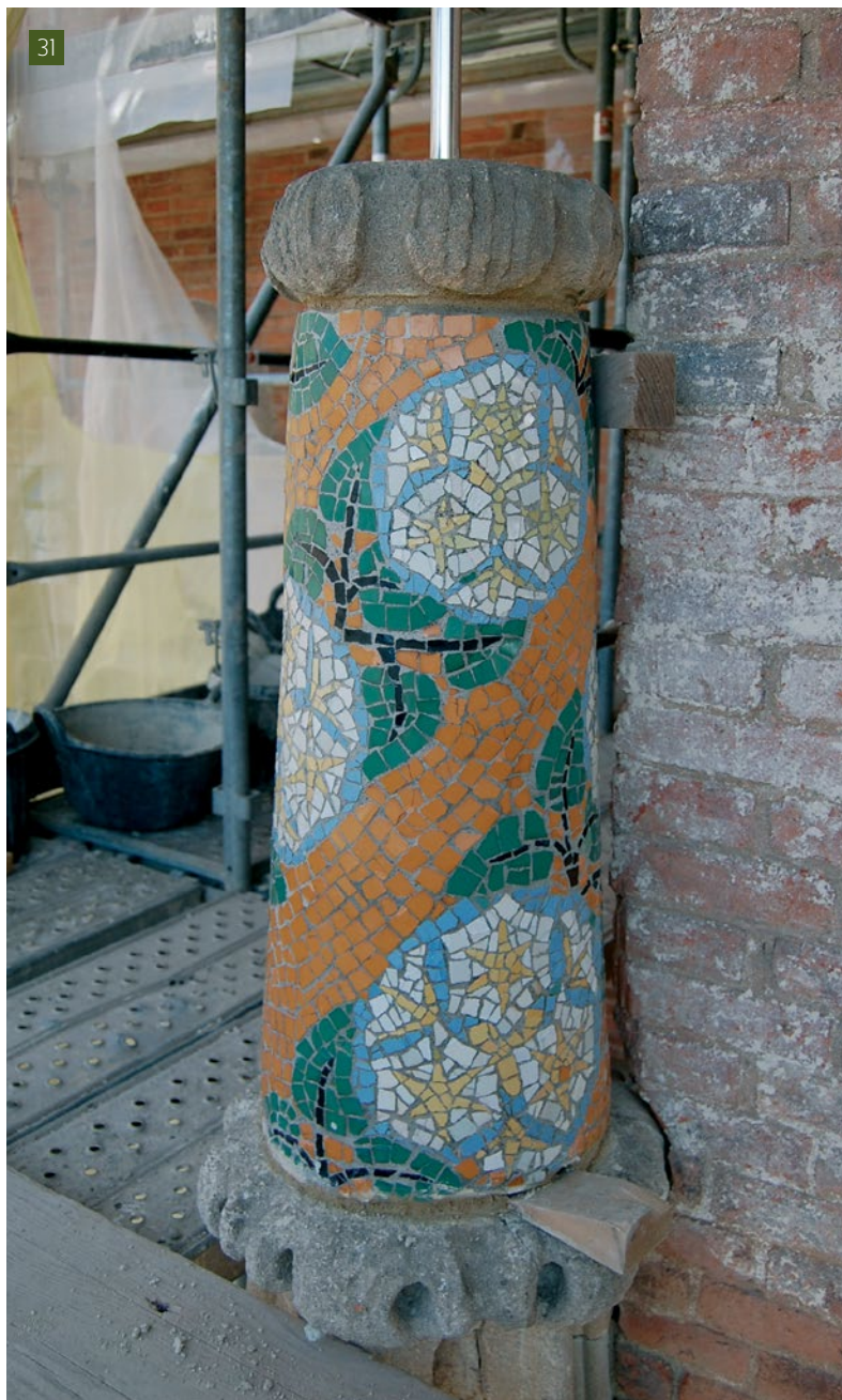
[31] Presentació del pinacle al seu emplaçament original, tram D P6 (Fotografia: Àbac).
